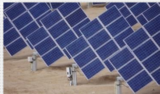
Hot & Sandy 130MW, Golmud, China
