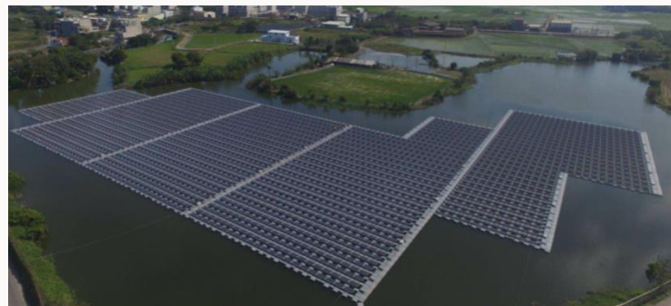
臺灣台南（颱風區） 裝機容量：3.1MW
