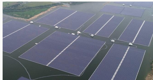
濟寧微山 裝機容量：31MW
