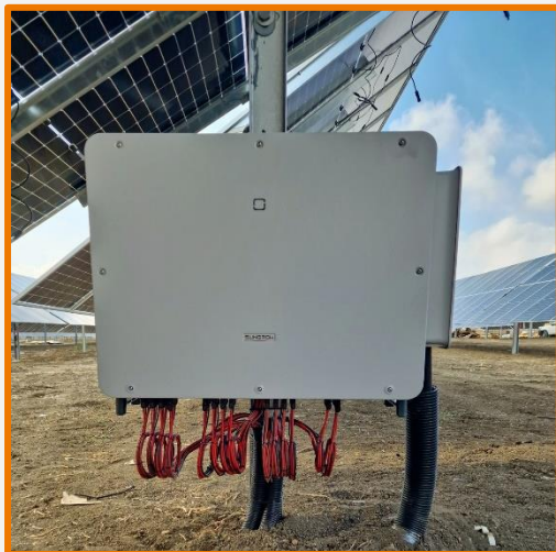
Centrale au sol
