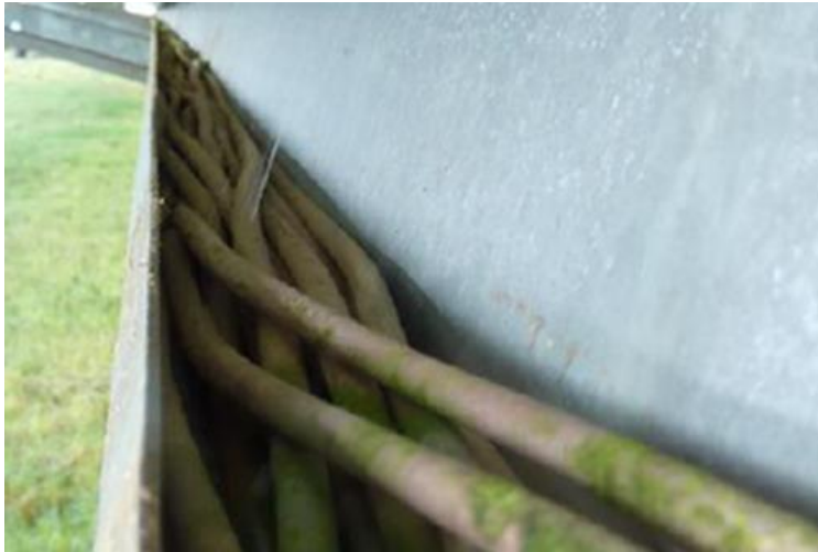
Couche isolante du câble DC endommagée
