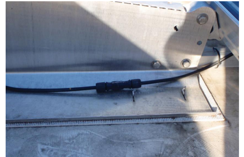
Connecteur détérioré au contact de pièce métallique
